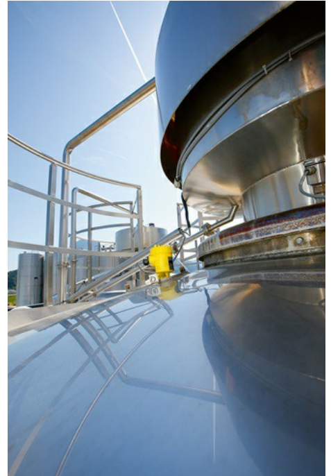
Der VEGAPULS 64 misst zuverlässig den Füllstand in den Molketanks.
