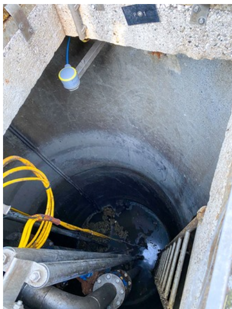
Espacios estrechos en el pozo de bombeo de Hart
