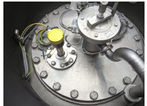
Das Radarfüllstandmessgerät VEGAPULS 64 übernimmt die Inhaltsmessung.
