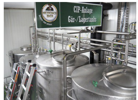
Weitere Druckmessumformer kommen im CIP-Tank zum Einsatz.
