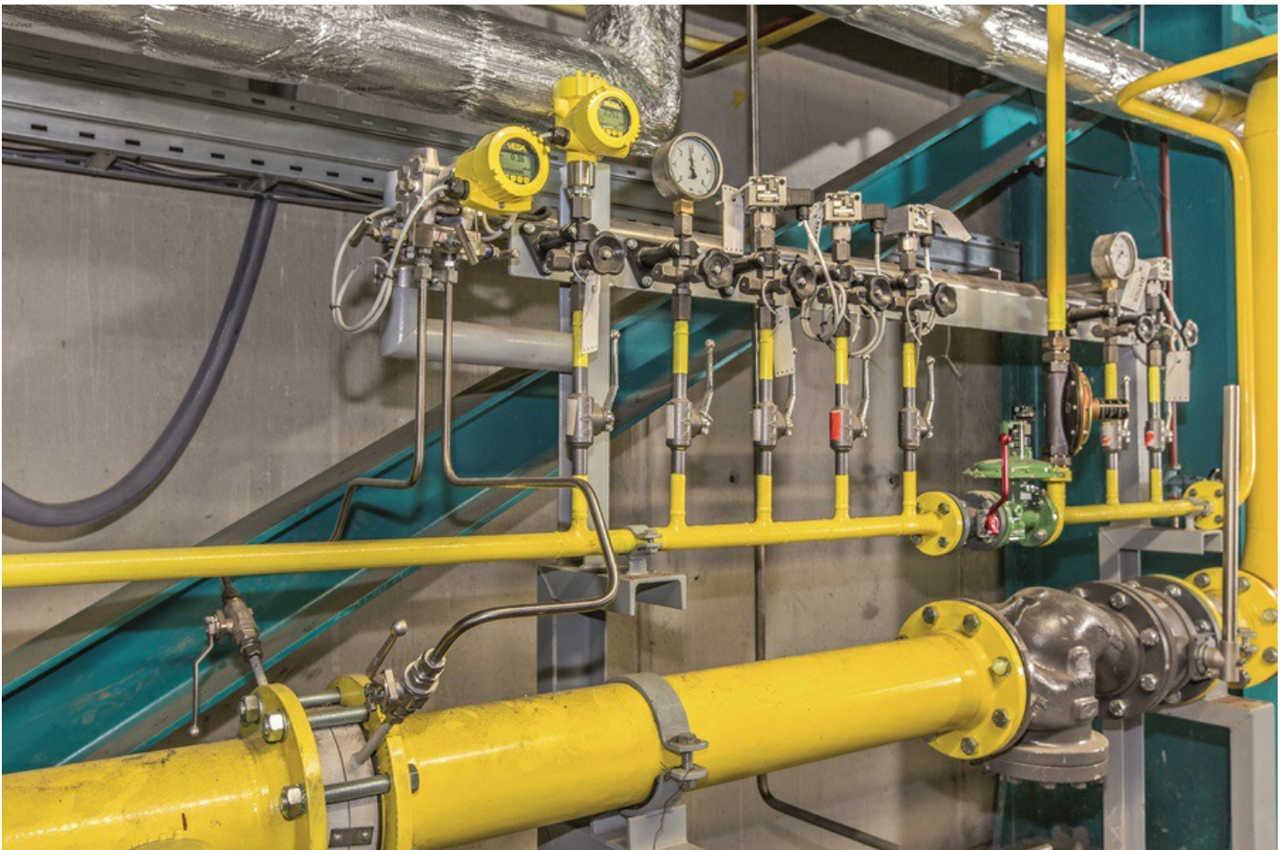
Durchflussmessung über Messblende und klassischen Differenzdruck. Der statische Druck wird über einen zusätzlichen Sensor erfasst.
