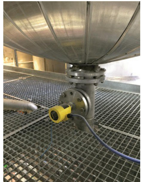
Primary-Sensor bei einer elektronischen Differenzdruckmessung in einem Destillationskessel.
