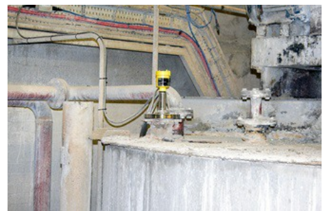
Der 80 GHz-Radarfüllstandsensor VEGAPULS 64 von VEGA misst präzise den Füllstand am Rand des Kalkmilch-Mischbehälters.
