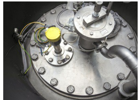
Das Radarfüllstandmessgerät VEGAPULS 64 übernimmt die Inhaltsmessung.
