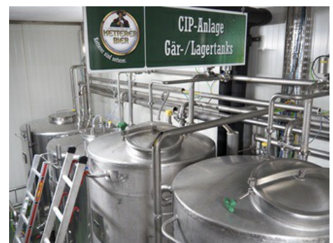
Weitere Druckmessumformer kommen im CIP-Tank zum Einsatz.
