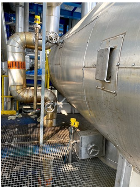
De geleide radarsensoren van het type VEGAFLEX 81 meten de interface in de 3-fasen scheidingsdecanter.
