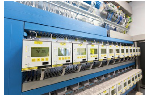
Steuerschrank mit Auswertgeräten VEGAMET 624 für das unterirdische Lösemittelager.
